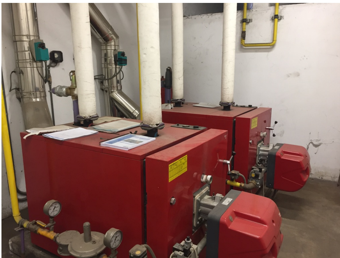
Figura 3. Vista de la sala de calderas polideportivp
