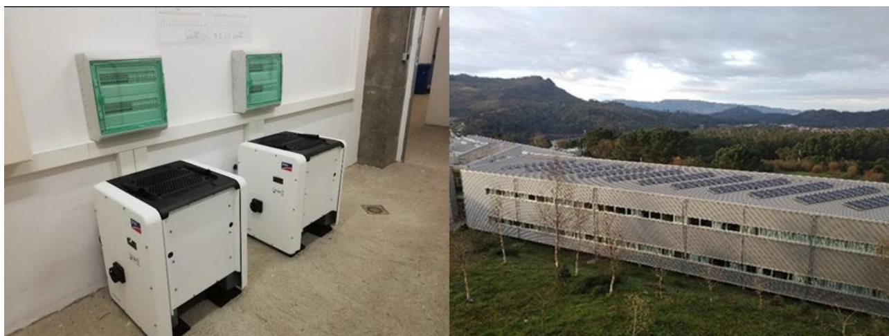
Figura 1. Inversores y cubierta fotovoltaica de la Escuela de Ingeniería de Minas y Energía. Fuente: Universidade de Vigo (2026a, figura 3).
