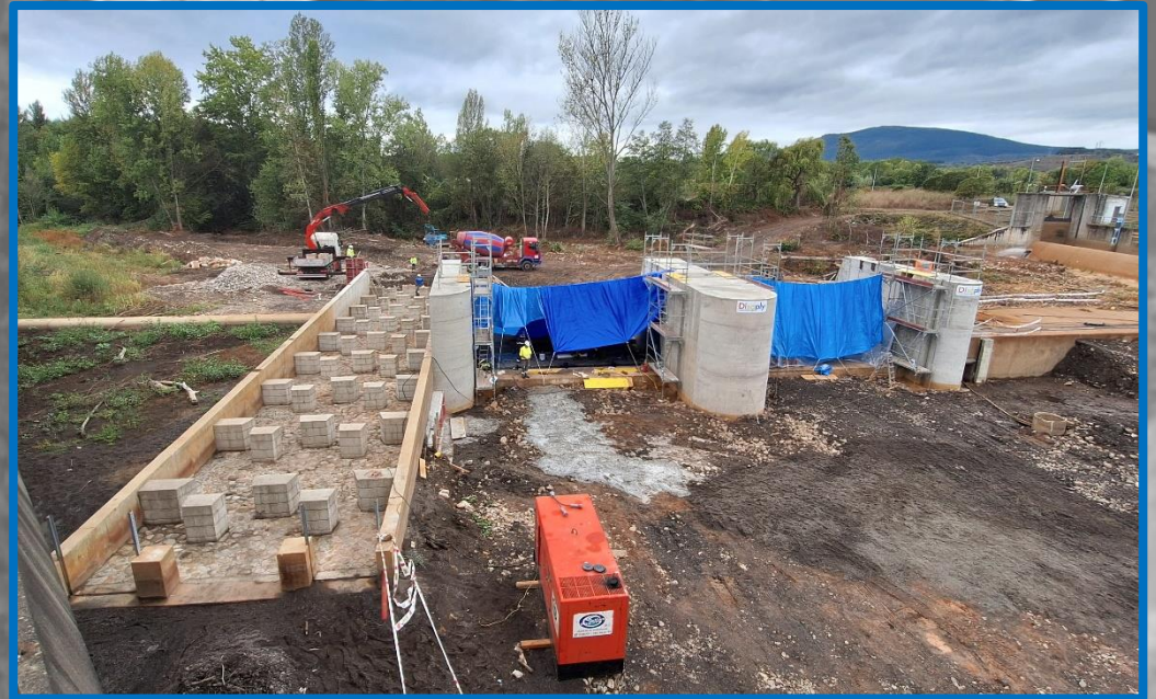
2ª fase: compuertas paso sedimentos
