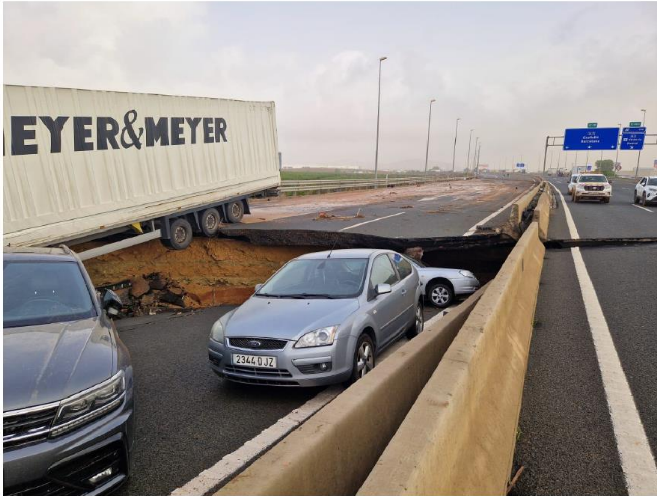
Graves daños en la Autovía A-7 zona Quart de Poblet (by pass zona sur)
