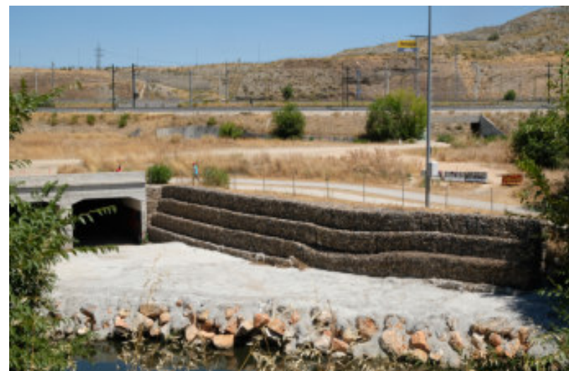
Estado actual del aliviadero del tanque de tormentas de Abroñigales.
