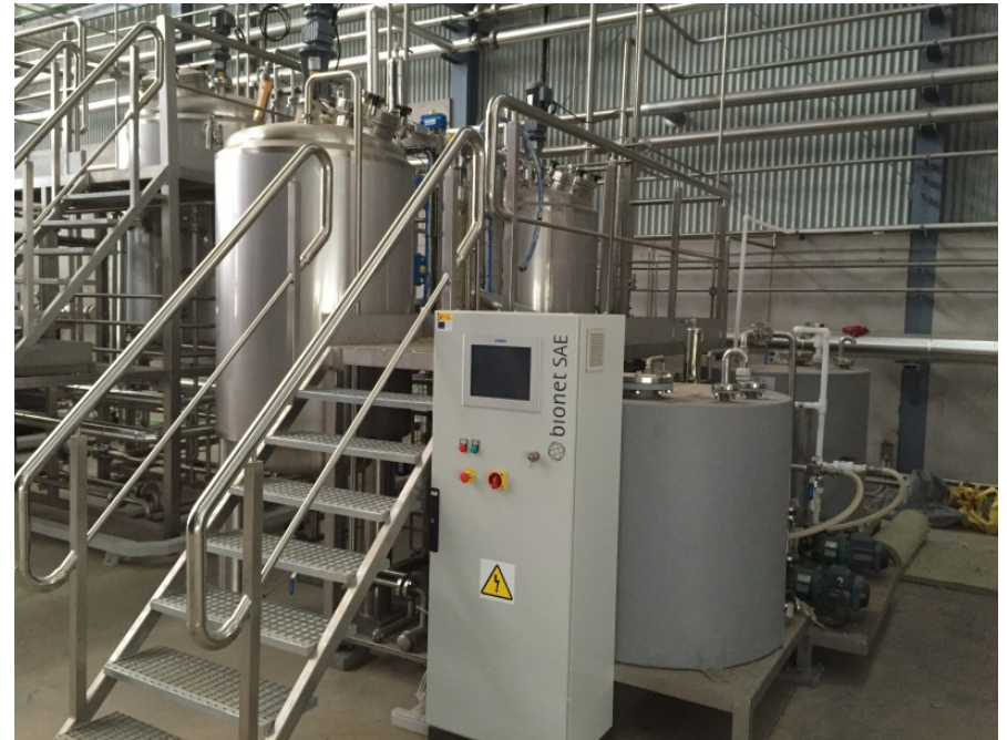
Sistema de adición de estériles: nutrientes, ácido, base y antiespumante
