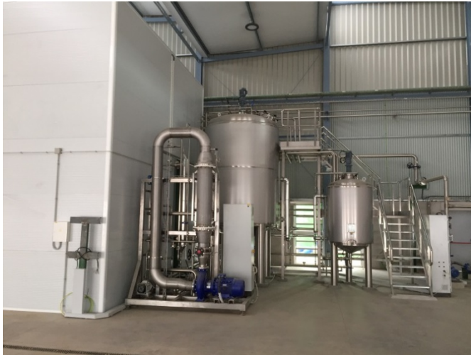
Área no ATEX con Sistema de microfiltración
