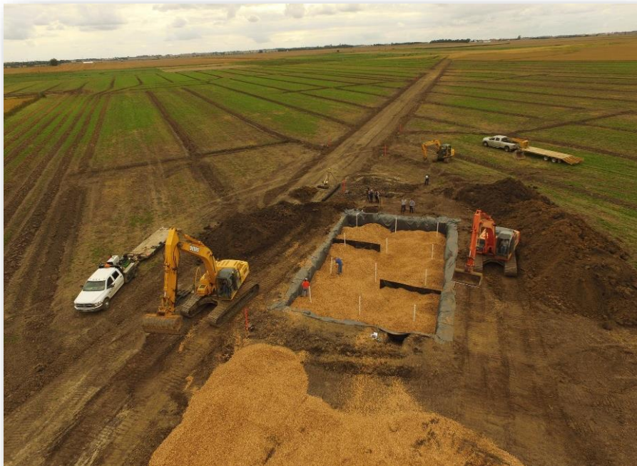
Relleno de un biorreactor con virutas de madera (EEUU)
