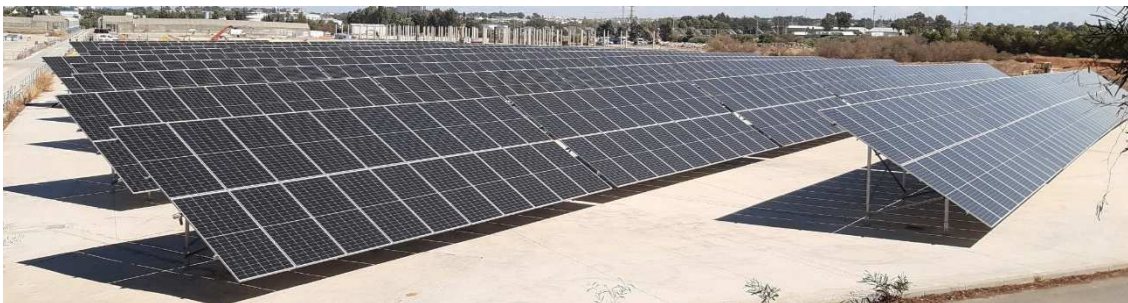
Foto 5: Planta solar fotovoltaica
