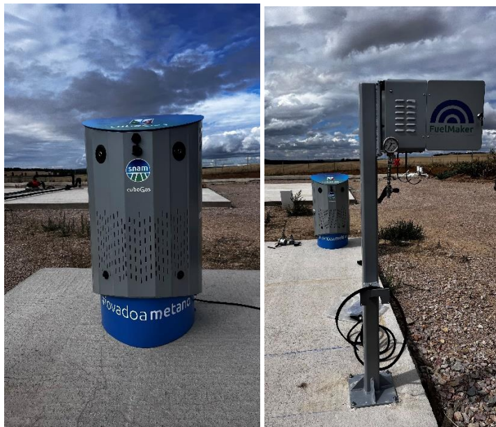
Figura 18. Compresor y dispensador de biometano (gasinera)
