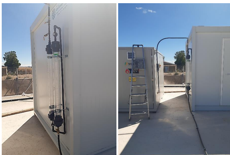
Figura 13. Conexiones biogás bruto digester, instalación de filtros y alimentación gas caldera
