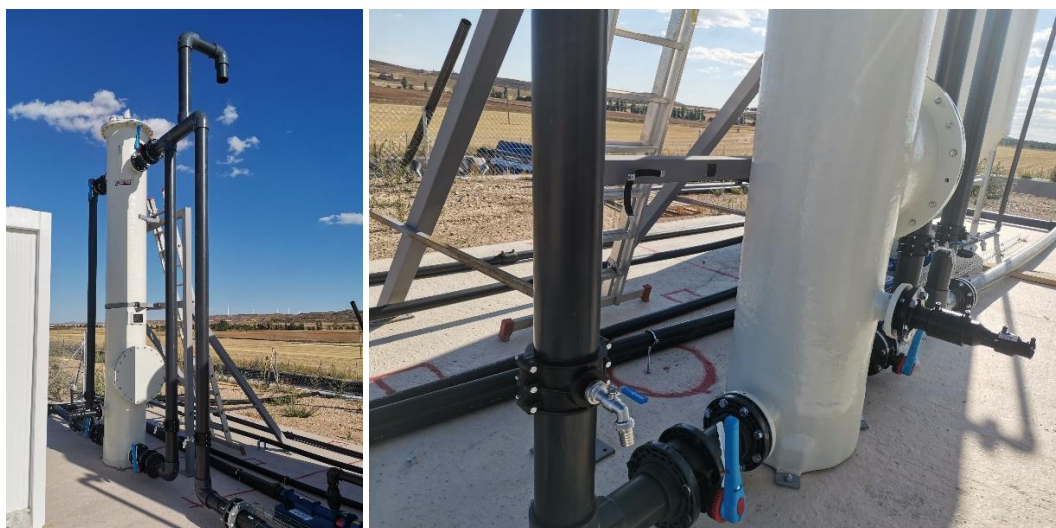
Figura 16. Columna de absorción, conexiones y toma de muestras
