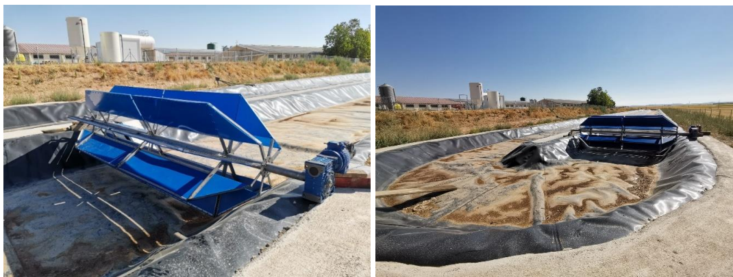
Figura 17. Instalación paddle Wheel
