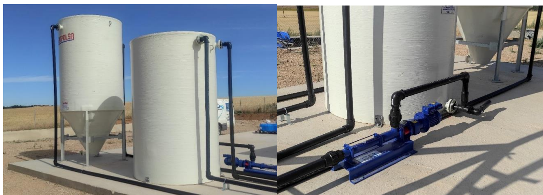
Figura 15. Sedimentador (1-izqda) y tanque de mezcla (1-dcha) con bomba
