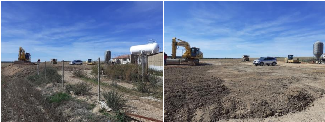
Figura 5. Inicio de obra civil y Preparación de terreno para movimiento de tierras
