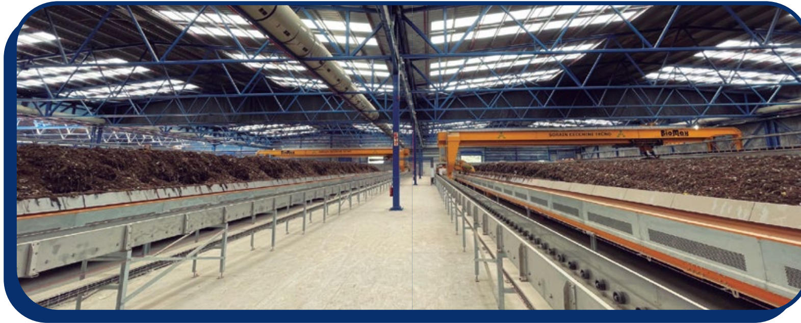
Panorámica de los biorreactores
