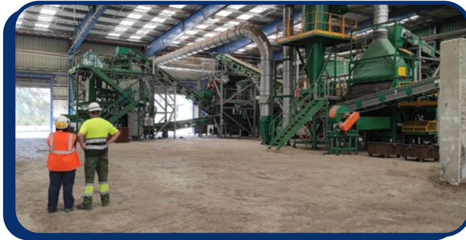
Panorámicas de la nueva instalación
