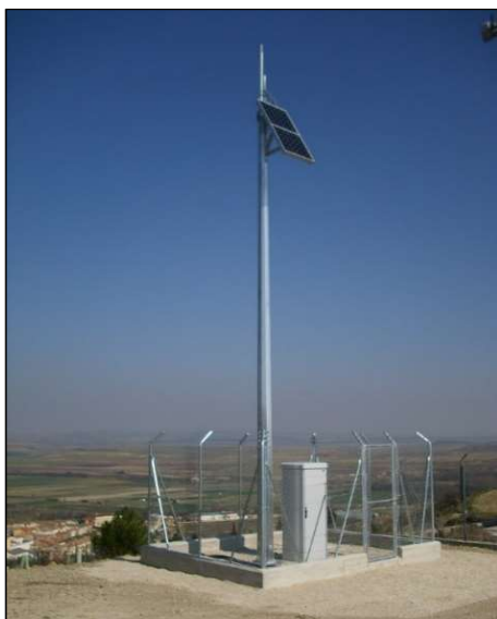
Figura 12. Estación meteorológica instalada en la localidad de Miranda de Arga, de propiedad y mantenida por la CHE.
