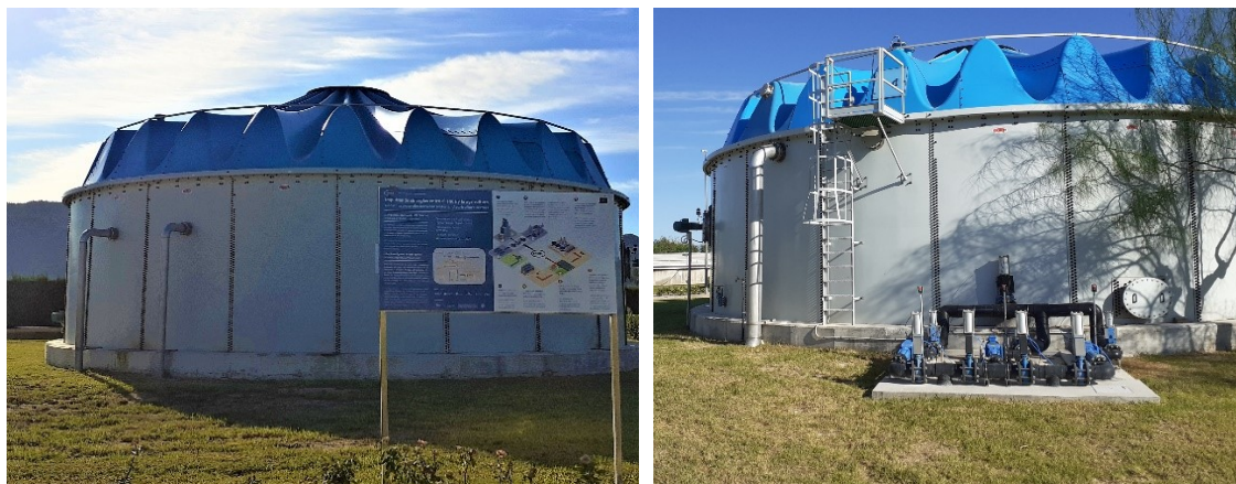
Figura 4. Tanque de almacenamiento adicional (depósito de elutriación).
