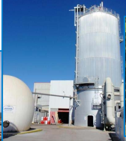
Planta de biogás en Terrassa (Barcelona) tratando FORM
