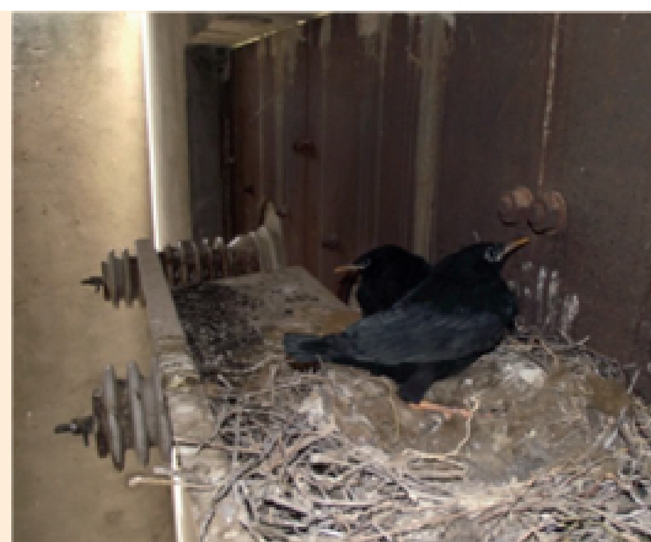
Nido de Chova piquirroja sobre una plataforma en el interior de un transformador en desuso, albergando pollos a punto de volar
