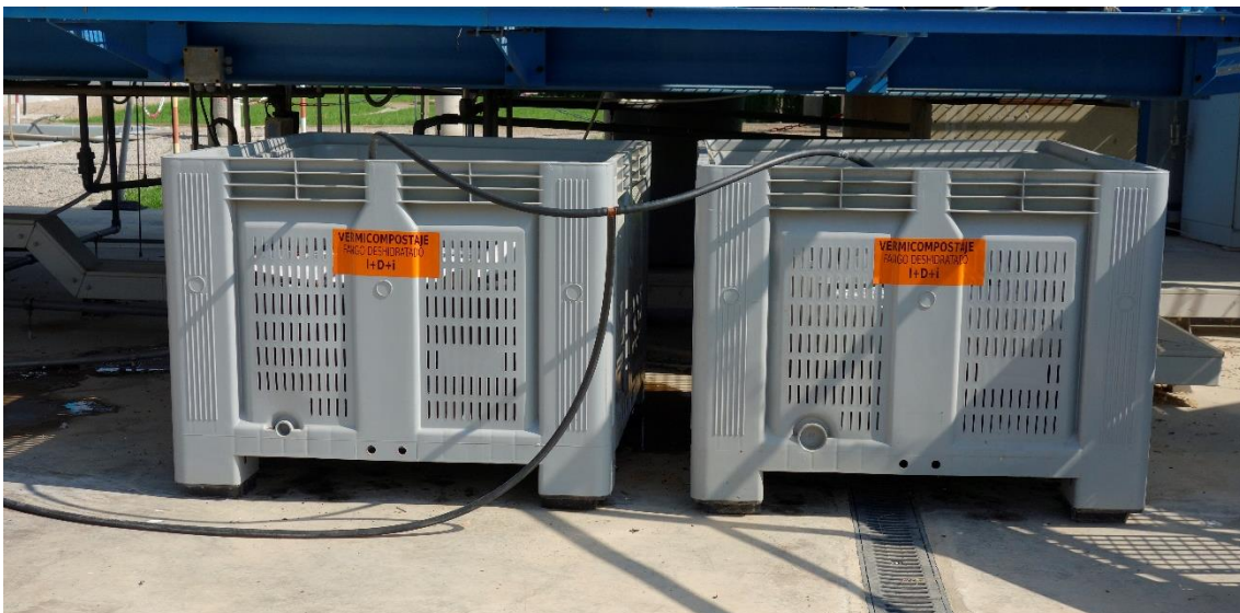
Figura 3. Vista de los contenedores instalados en la EDAR Murcia Este.
