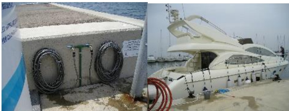
Figura 22. Instalación para el suministro del agua reciclada para la limpieza de las embarcaciones. Fotos cedidas por Port de Roses.
