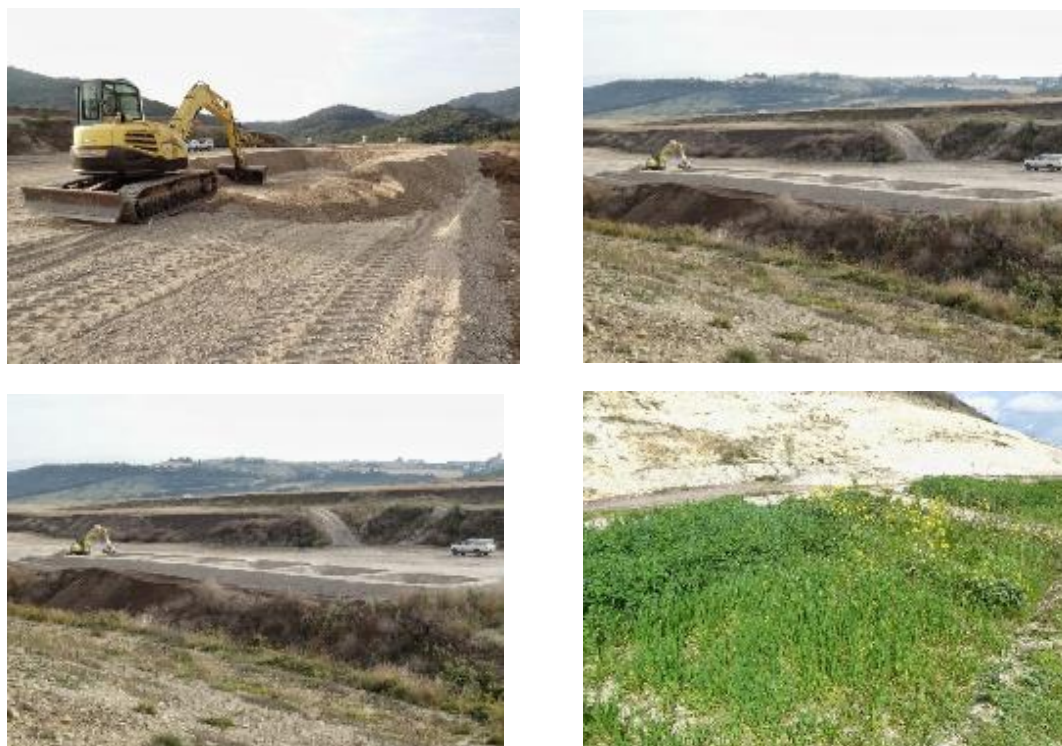
Figura 56: Imágenes del proyecto “Tecnosuelos Gardelegi”. Fuente: Ayuntamiento de Vitoria-Gasteiz.
