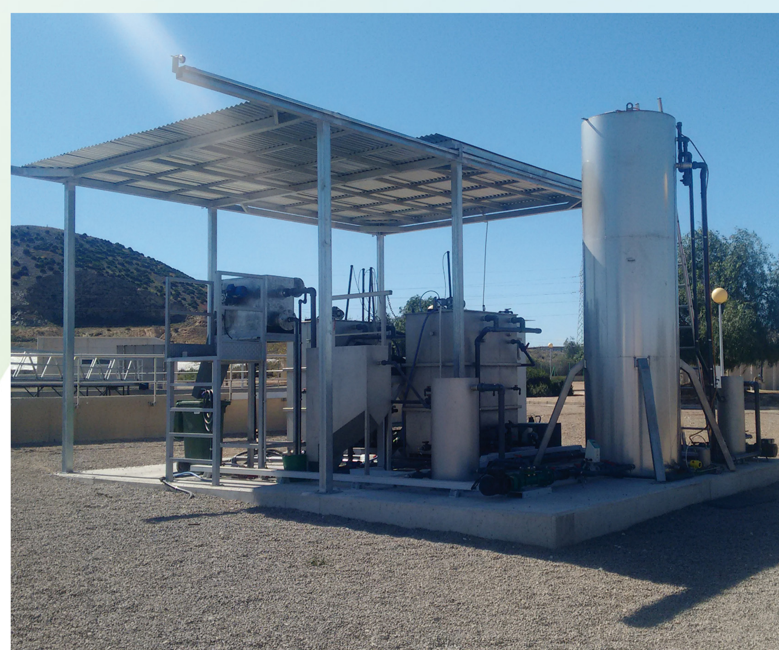
Figura 1. Vista de la planta piloto LIFE SIAMEC en la EDAR Cabezo Beaza.
