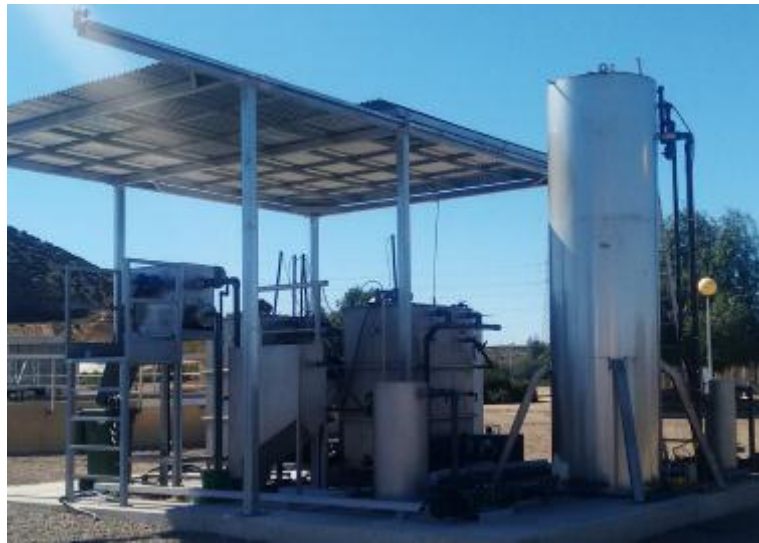
Figura 7. Vista del reactor UASB.
