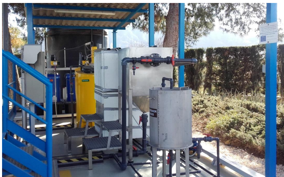
Figura 4. Vista de la planta piloto IGNIS FUNGUS.
