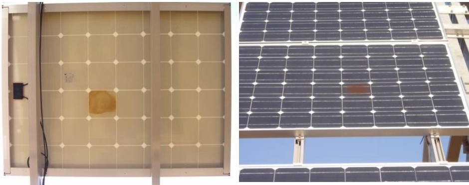
Fig. 2.1. Defectos que se observan a simple vista.
