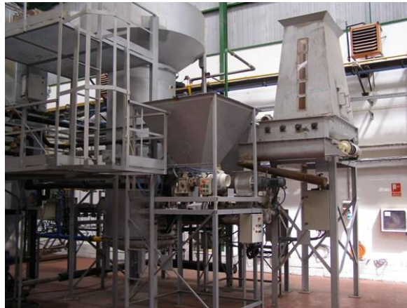
Figura 2. Detalle de la planta piloto de combustión en lecho fluidizado burbujeante.
