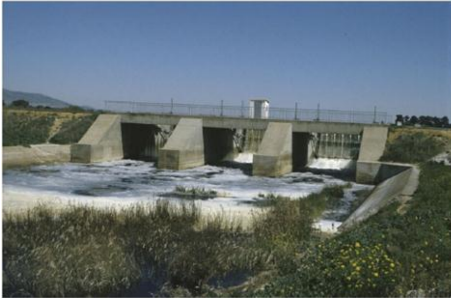
Figura 18. Presa de Puente Navarro situada en la parte suroccidental del Parque. Fuente: Castaño Castaño, S. 2008.
