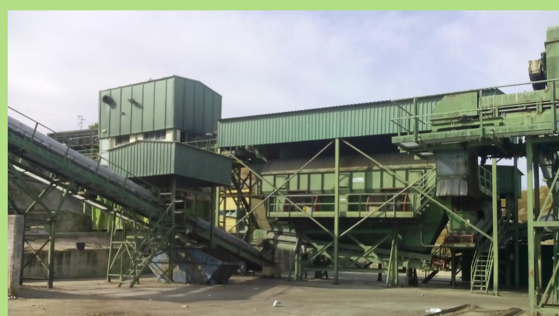
Equipos de selección y separación de los RSU
