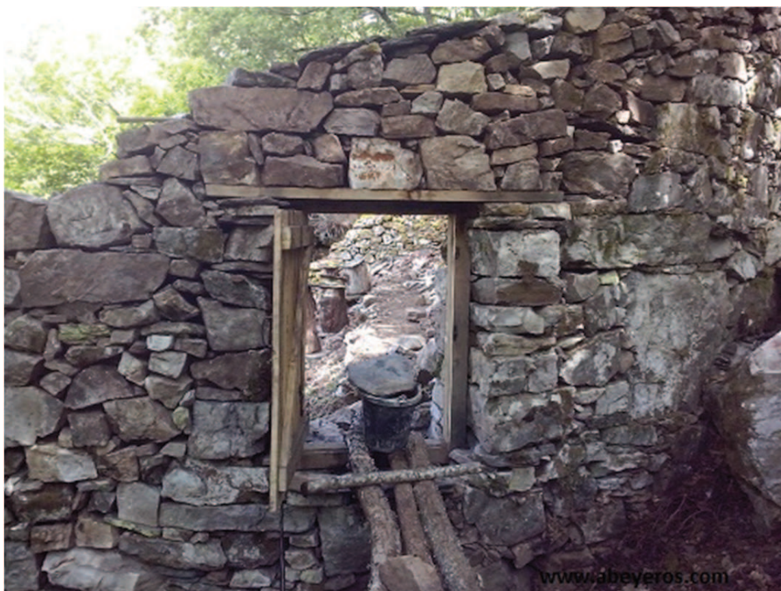
Detalle de la puerta y el foso
