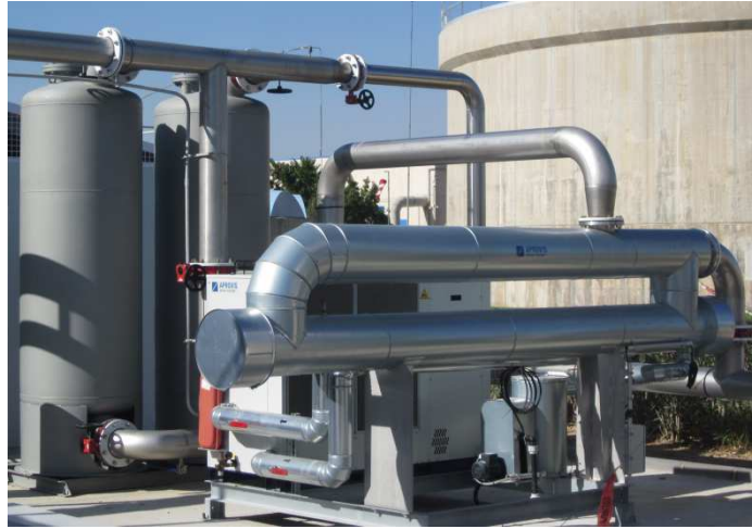
Figura 3. Detalle del intercambiador de calor y de las columnas de carbón activo.
