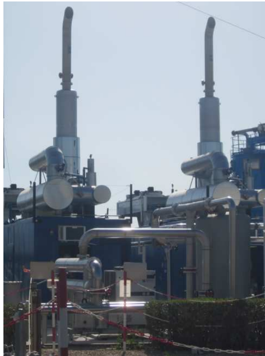
Figura 4. Vista frontal de las cabinas de los motores instalados en la EDAR Murcia Este.
