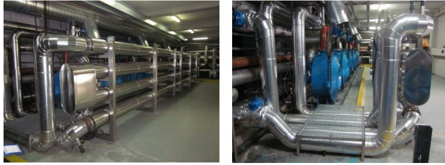
Figura 7. Intercambiador de calor.
