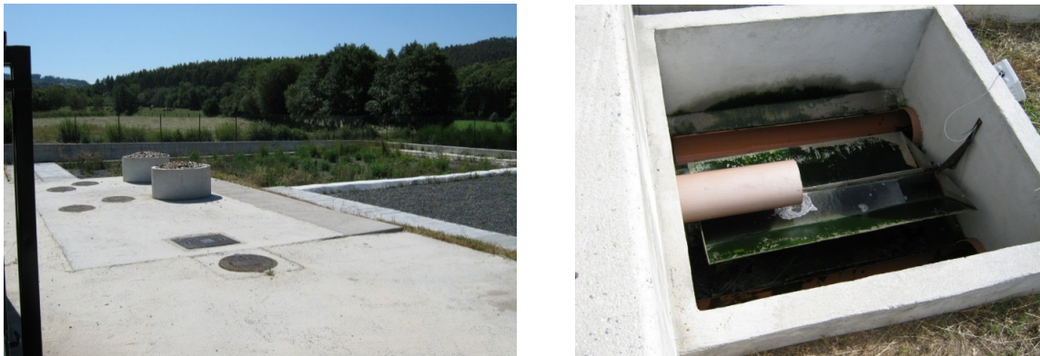
Figura 2.- Izda.: aspecto de la EDAR a 30 de junio del 2011, se destaca en primer plano los filtros de malos olores de la fosa séptica, y en el siguiente la celda derecha (todavía sin vegetación) e izquierda del humedal. Dcha.: balancín de reparto del efluente primario de la fosa séptica, cuando ya se había instalado el controlador y registrador de pulsos (caja gris a la derecha de la imagen) para medir el caudal de tratamiento.
