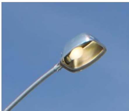
Figura 7. Luminaria vial abierta
