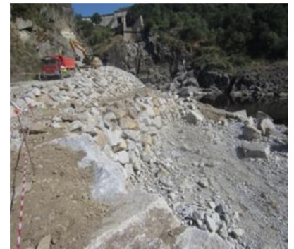
Vista de las escolleras inferior y superior a la berma intermedia que irán estaquilladas.
