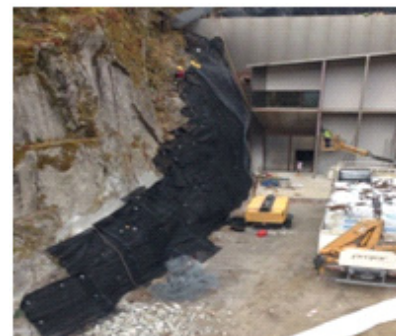
Parte exterior de la central y cobertura con malla volumétrica.
