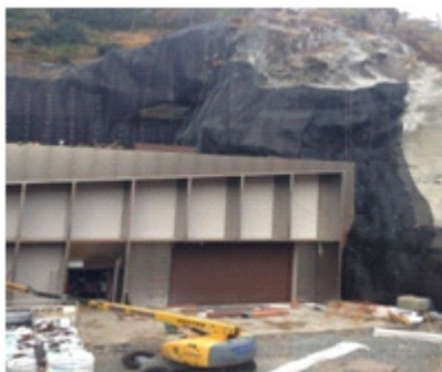
Vista de la parte exterior de la central y cobertura con malla volumétrica.
