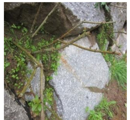
Detalle de estaquillas en escollera del talud superior a la rampa de acceso al cauce.
